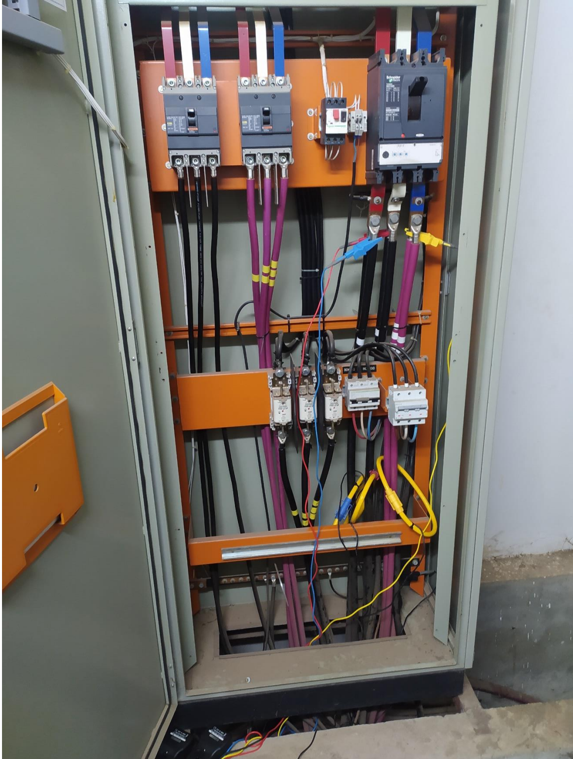
Figura G. 1- Tablero General de la parte de producción
