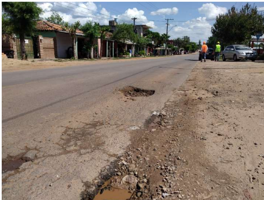
Falla tipo Bache- severidad Alta y piel de cocodrilo severidad alta pk: 15+300
