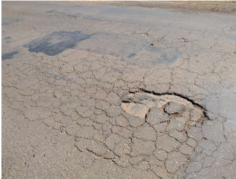
Falla tipo piel de cocodrilo – severidad alta Pk: 8+300
