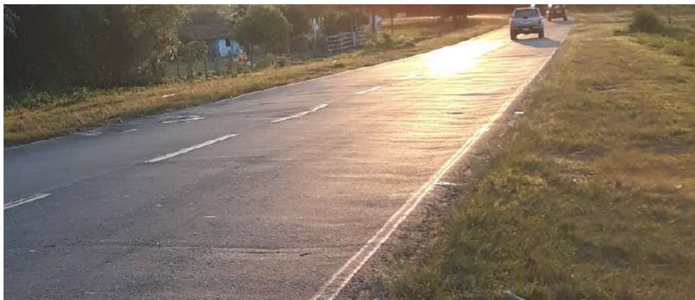
Falla de tipo Ondulaciones pk: 28+800
