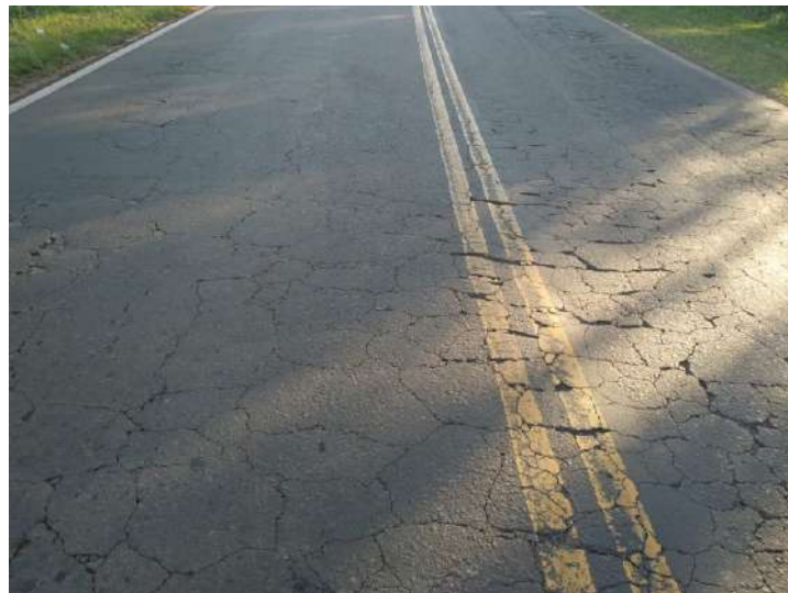
Falla tipo Piel de cocodrilo severidad alta Pk: 23+000
