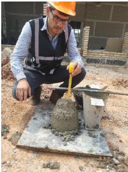
Ilustración 13: Preparación del hormigón para el ensayo de Asentamiento en la obra C- 12
