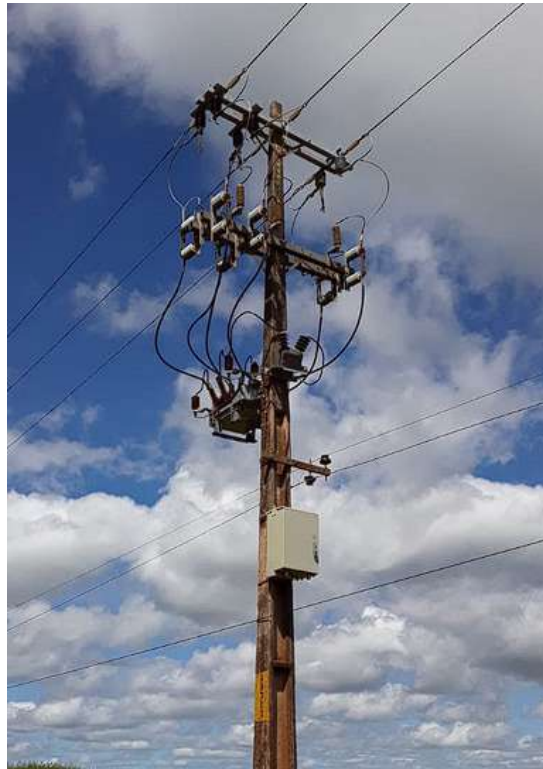
Figura 5.10: Equipo telecomandado, instalado por ANDE
