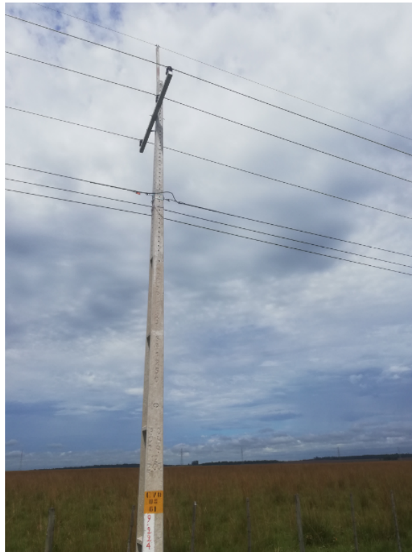
Figura 4.1: Hilo de guarda del alimentador COV08
