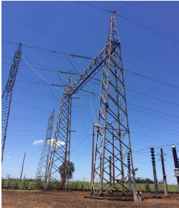
Figura 7. 1: Pórtico de Llegada de Línea.
