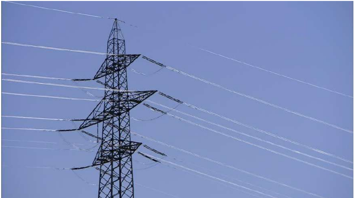
Figura 1. 4: Torre de Amarre.
