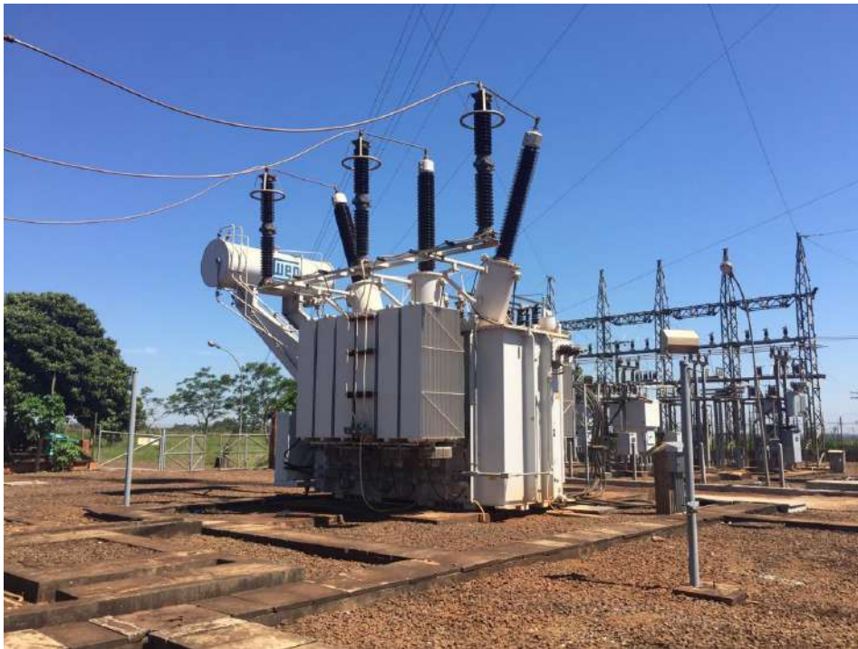
Figura 3. 1: Transformador de Potencia de la Estación Campo Dos.
