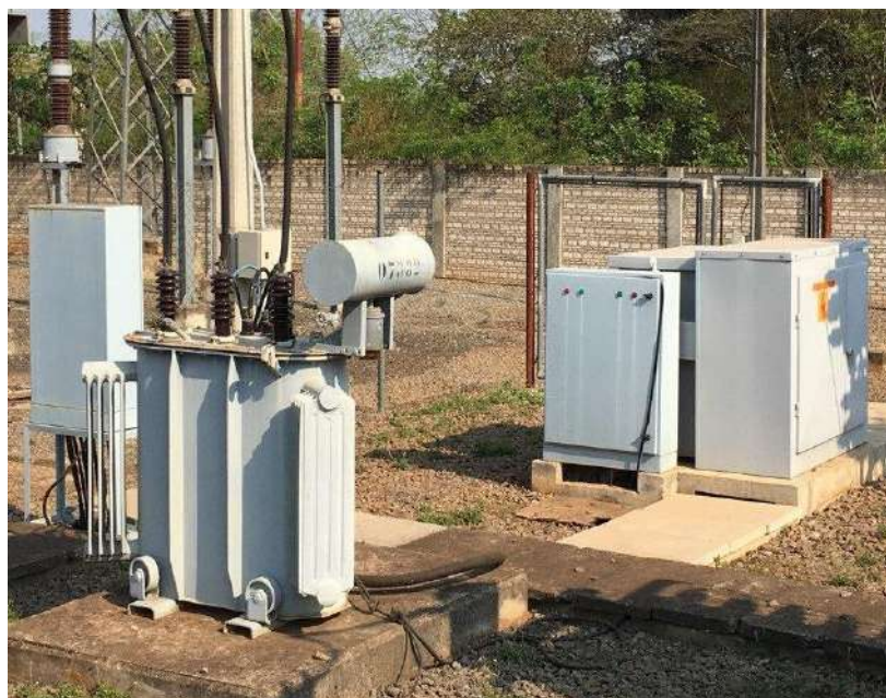
Figura 7.1: Vista de transformadores de SSAA
