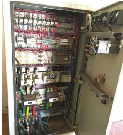
Figura 7.6: Tablero de transferencia de RED-GGE
