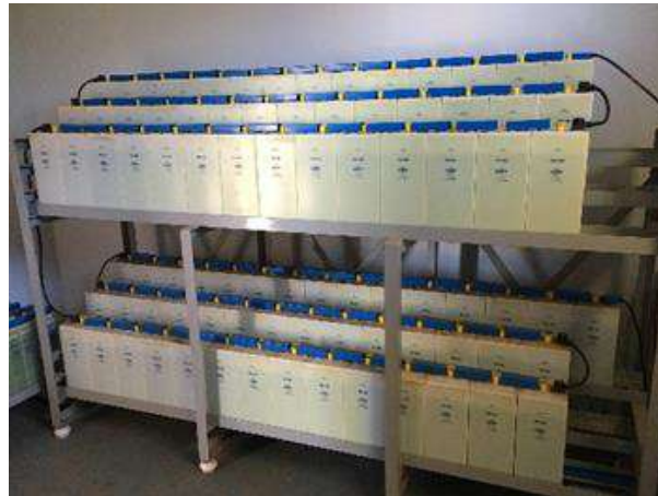
Figura 7.9: Banco de batería
