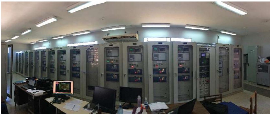
Figura 7.10: Sala de protección y control
