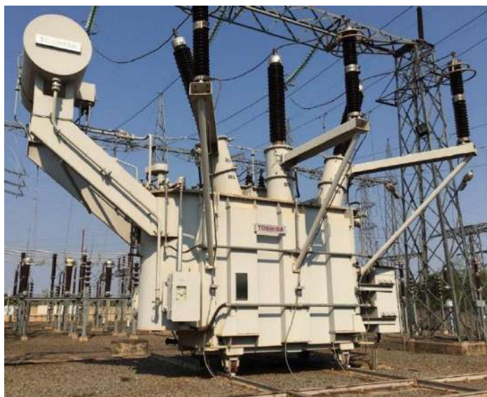
Figura 7.3: Vista TR-02 220/23 kV
