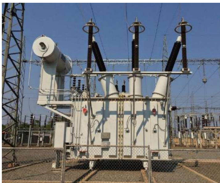
Figura 7.4: Vista TR-03 220/23 kV
