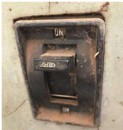
Figura 7.8: Vista del interruptor termo-magnético
