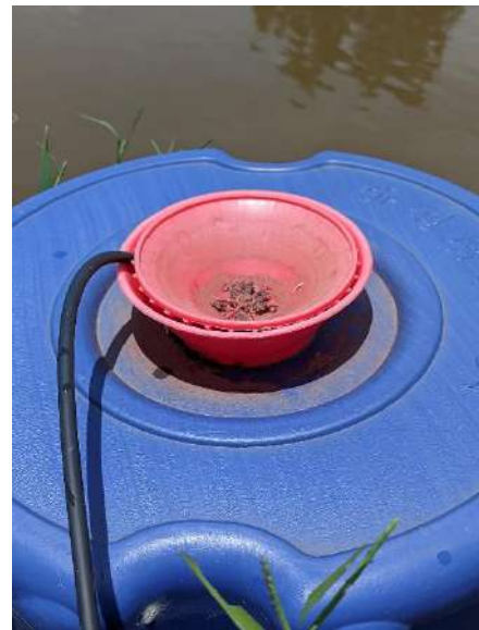
Figura 5.18. Bombas peristálticas conectadas a las mangueras de dosificación, con descarga cercana al aireador para favorecer la recirculación de la solución
