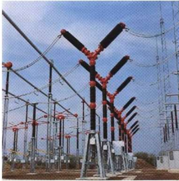
Figura 6 - Interruptor de Potencia en SF6
