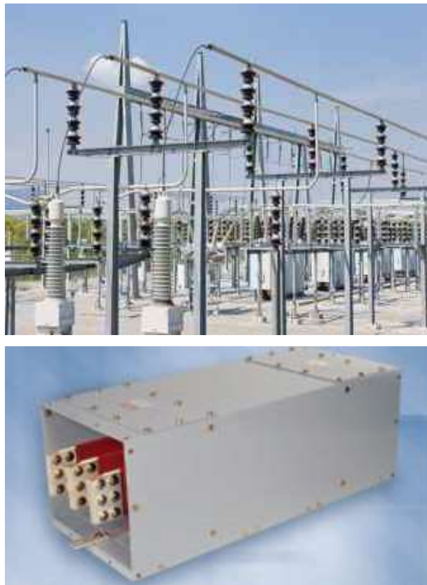
Figura 7 - Barras de media tensión, externas e internas
