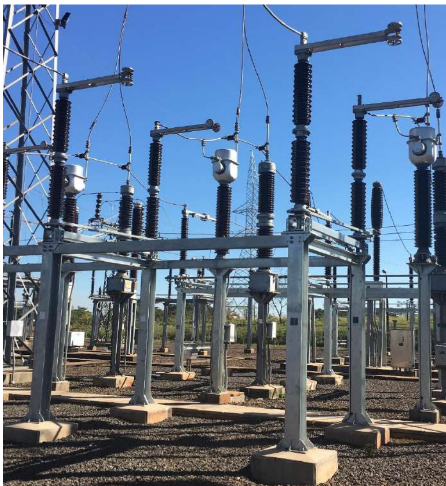
Figura 7.3: Seccionador para 220 kV a dos columnas con apertura central lateral
