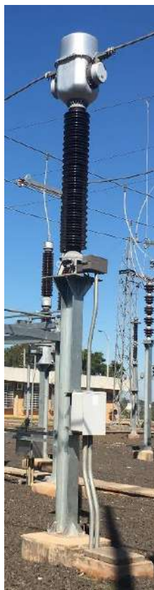
Figura 7.4: Transformador de corriente para 220 kV
