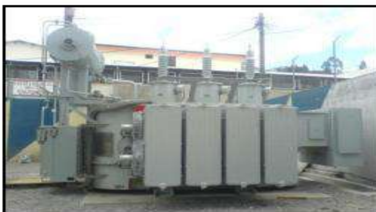
Figura 3.1: Transformador de Potencia
