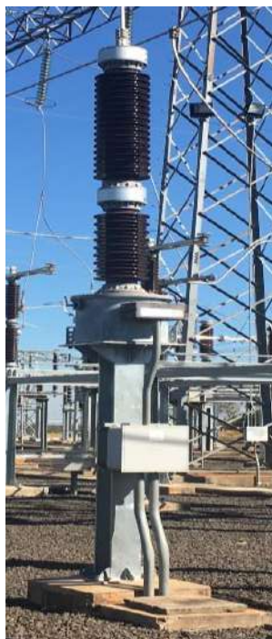
Figura 7.5: Transformador de tensión para 220 kV
