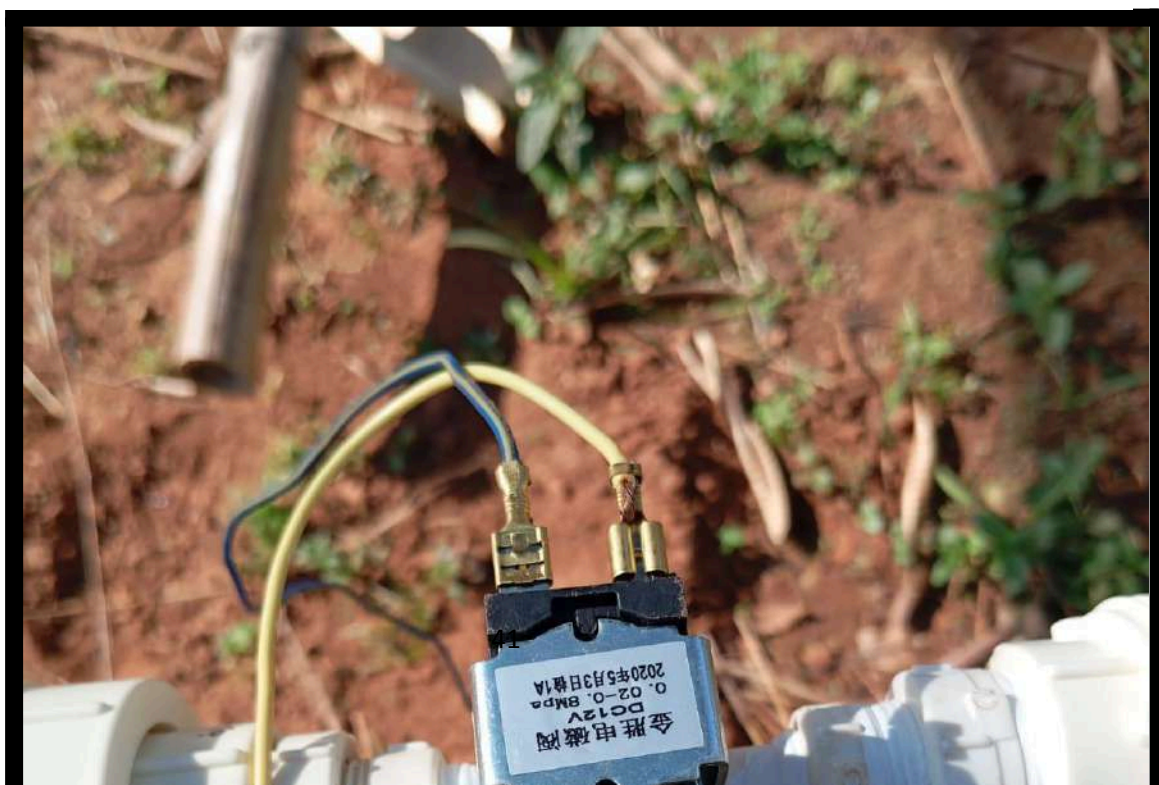
Ilustración SEQ Ilustración \* ARABIC 4 Electroválvula instalada
