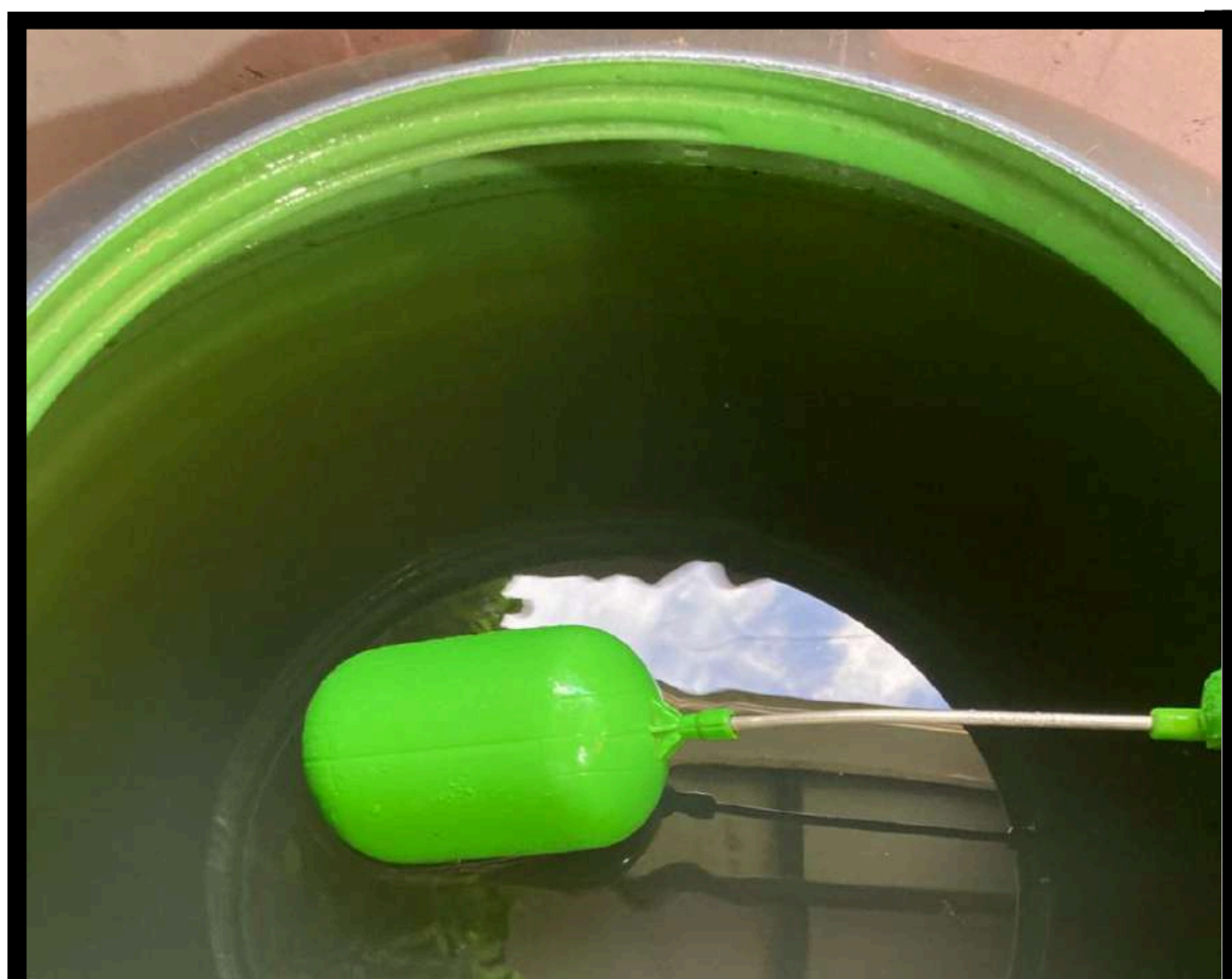
Ilustración 23 Tanque con la colocación de la boya electrica
