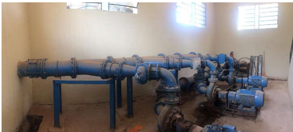
Figura 4.11: Bombas de agua
