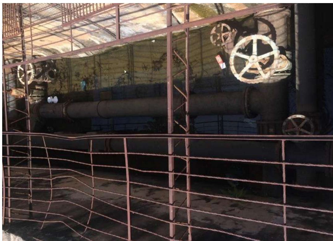
Figura 4.4: Cañerías de entrada y salida de agua
