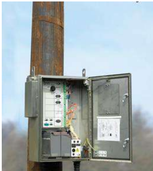
Figura 5.18: Unidad Terminal Remota (RTU) tipo poste [60]
