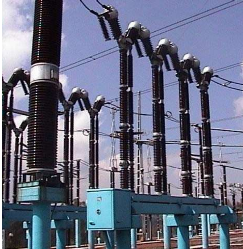
Gráfico 24. Interruptor en pequeño volumen de aceite marca Sprecher & Schuh de 115 kV con mecanismo de resorte. Manual de interruptores de potencia. Pág 80
