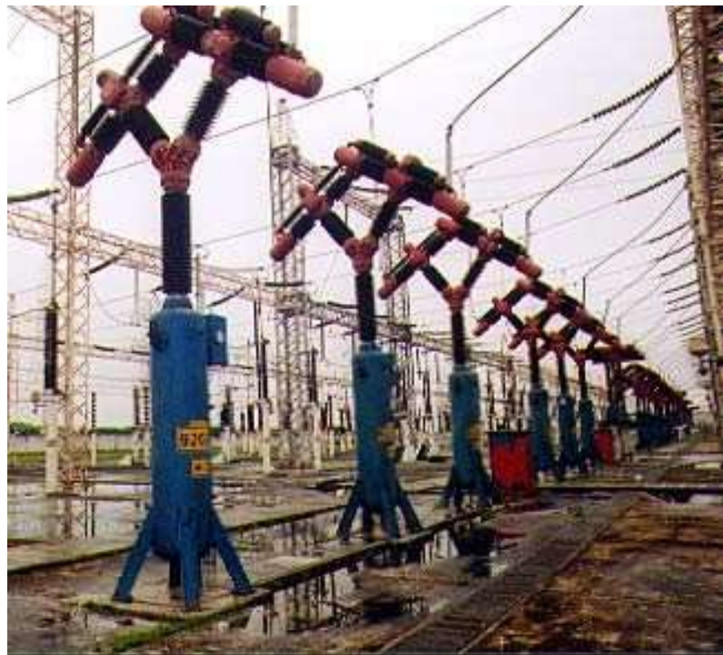
Gráfico 20. Interruptor de soplado de aire. marca Brown & Boveri, mecanismo neumático, 245 kV, 2000 A y 40 kA de capacidad interruptiva. Manual de interruptores de potencia. Pág. 75
