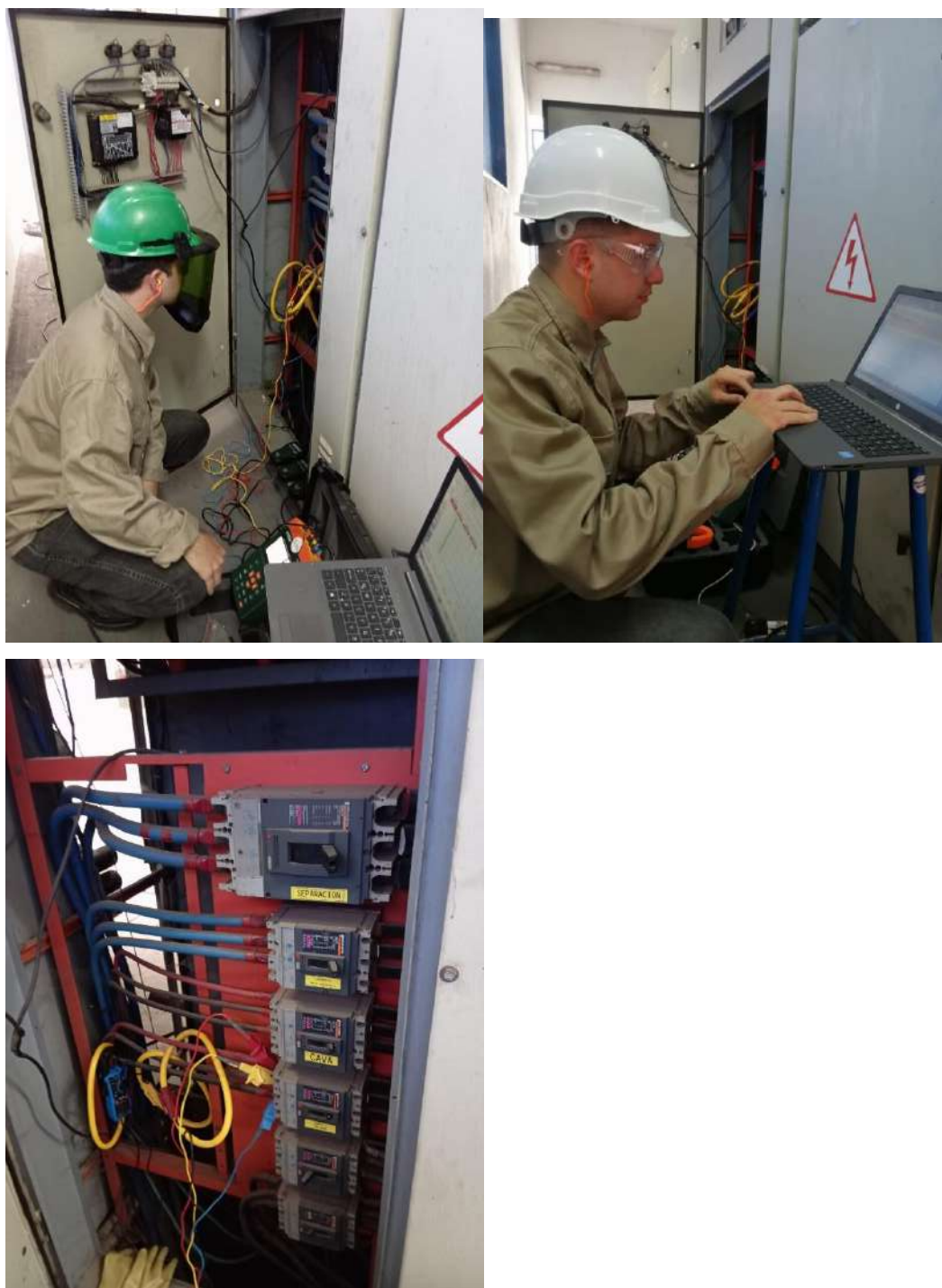
Figura 24. Imagen del tablero con las sondas de medición instaladas.
