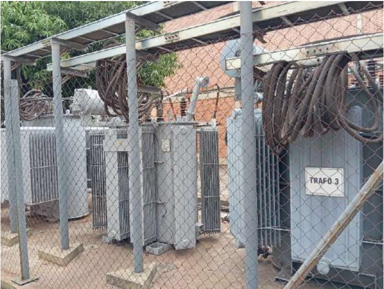
Figura 25. Unidades de transformadores de la marca WEG de 1500 kVA que alimentan la empresa PARALEVA.
