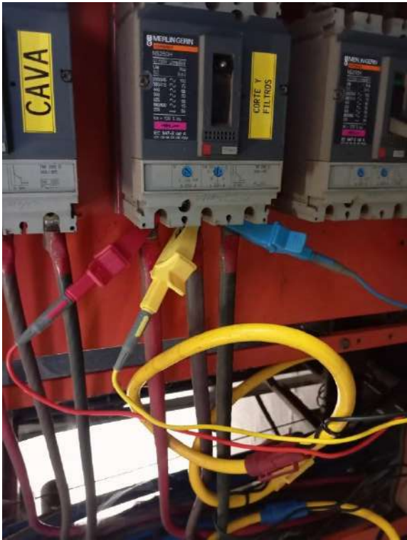
Figura 26. Interruptor caja moldeada de Filtro y Empaque.
