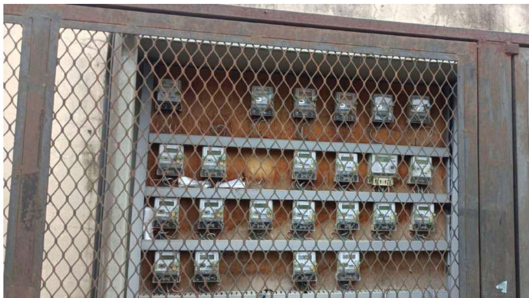
Figura 14. Tablero de Medidores.
