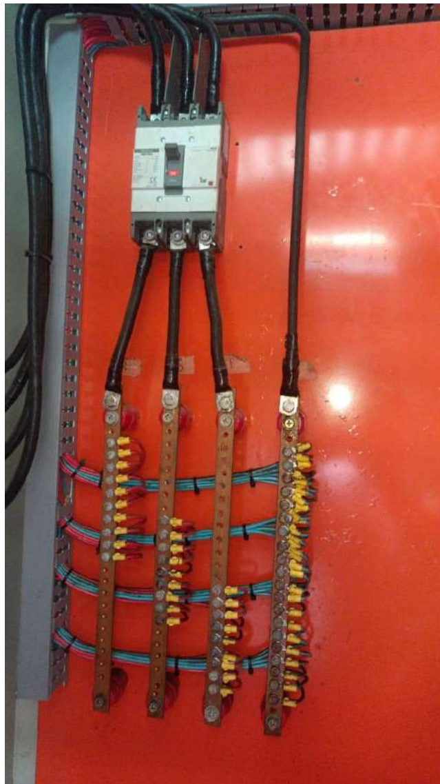
Figura 12. Tablero General del transformador 2.
