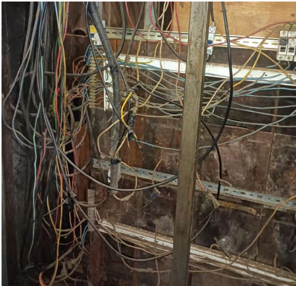
Figura 10. Tablero principal del transformador 1.
