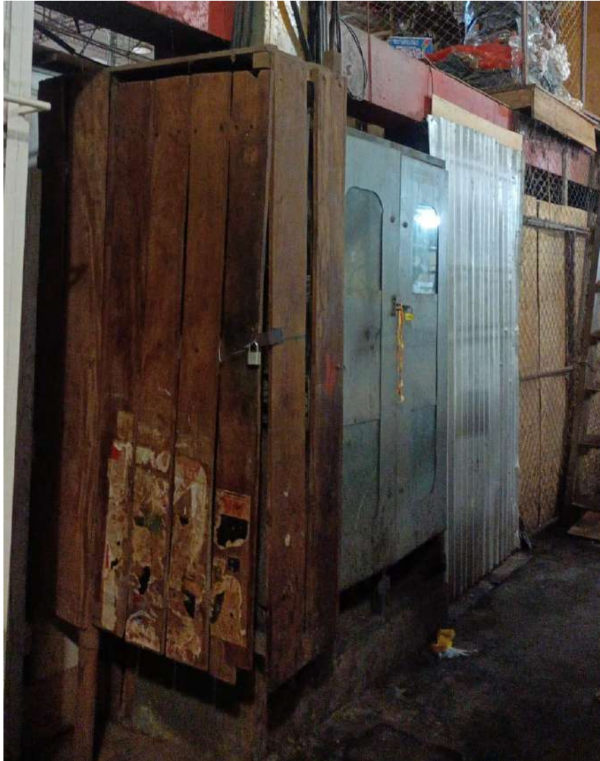
Figura 7. Tablero General y Principal del transformador 1.
