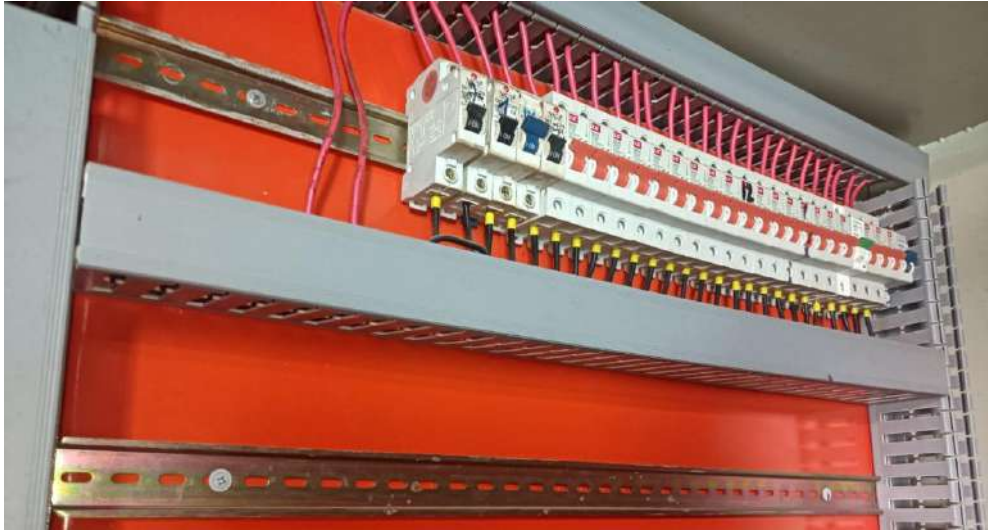
Figura 13. Tablero principal del transformador 2.
