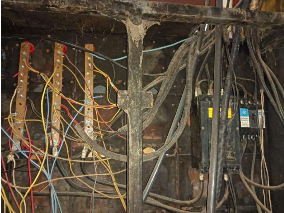
Figura 8. Interior del tablero general del transformador 1.
