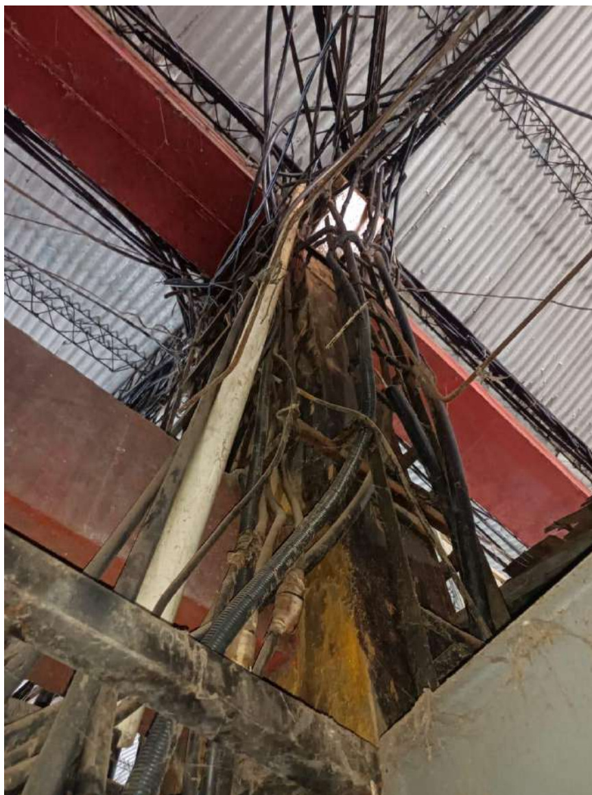
Figura 11. Columna montante del tablero General y Principal del transformador 1.
