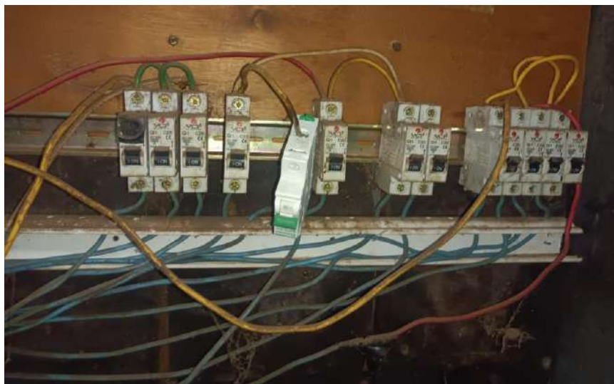
Figura 9. Tablero principal del transformador 1.
