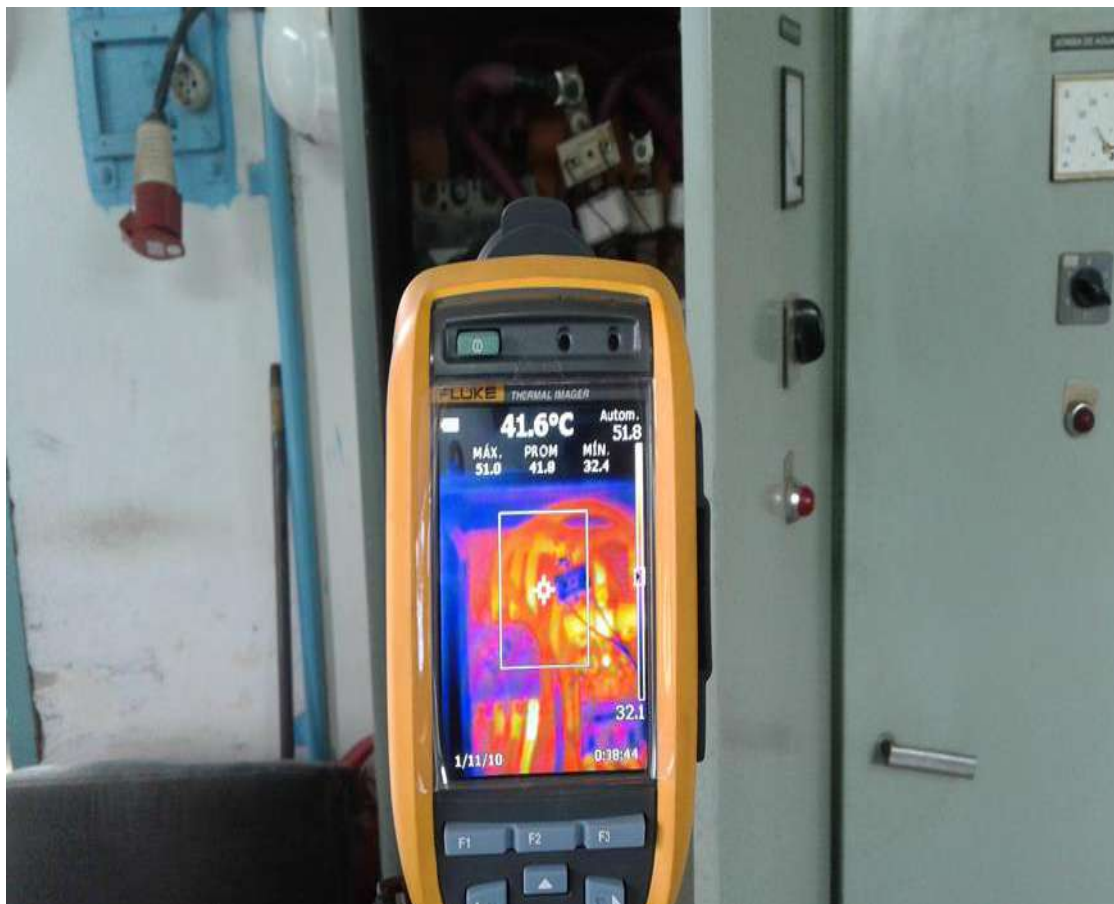
Figura B.4.2: Inspección térmica en tableros de motores críticos.
