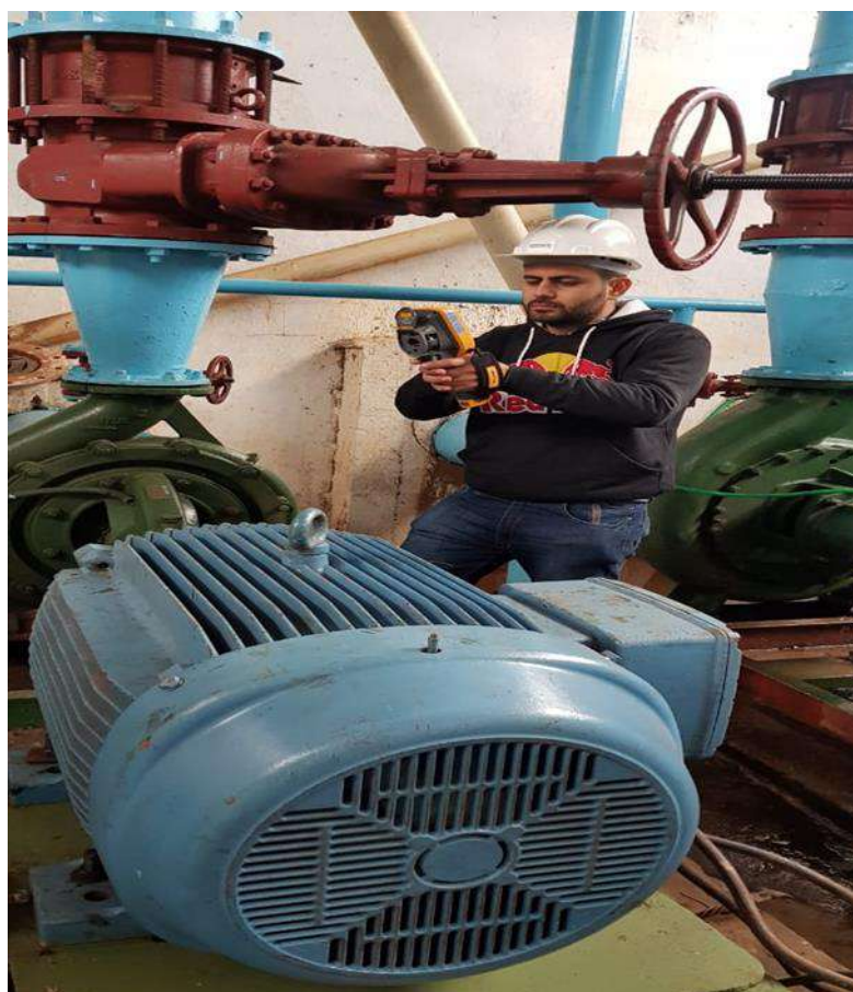
Figura B.4.1: Inspección térmica en motores críticos.
