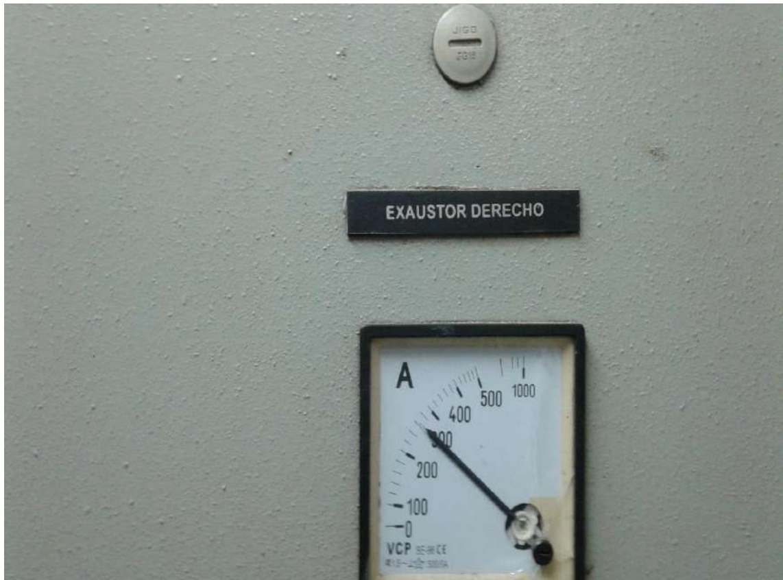
Figura B.2.2: Amperímetro en tablero del motor sector caldera.
