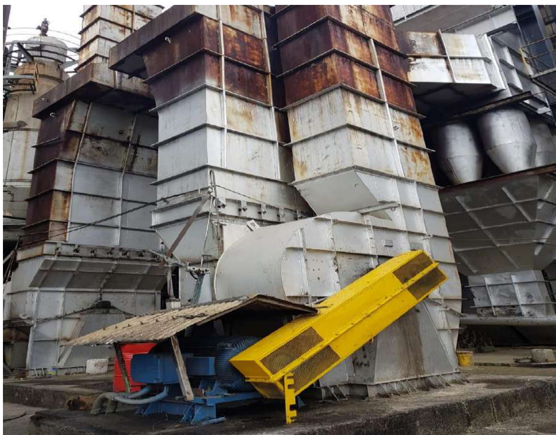
Figura B.2.1: Motor crítico del sector caldera.
