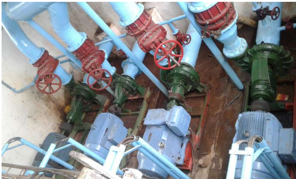
Figura B.3.2: Motores críticos del sector captación.
