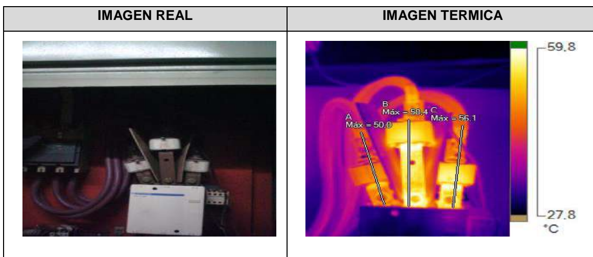
Figura 8.24: Imagen real y termica conductor fusible y contactos exhaustor izquierdo.
