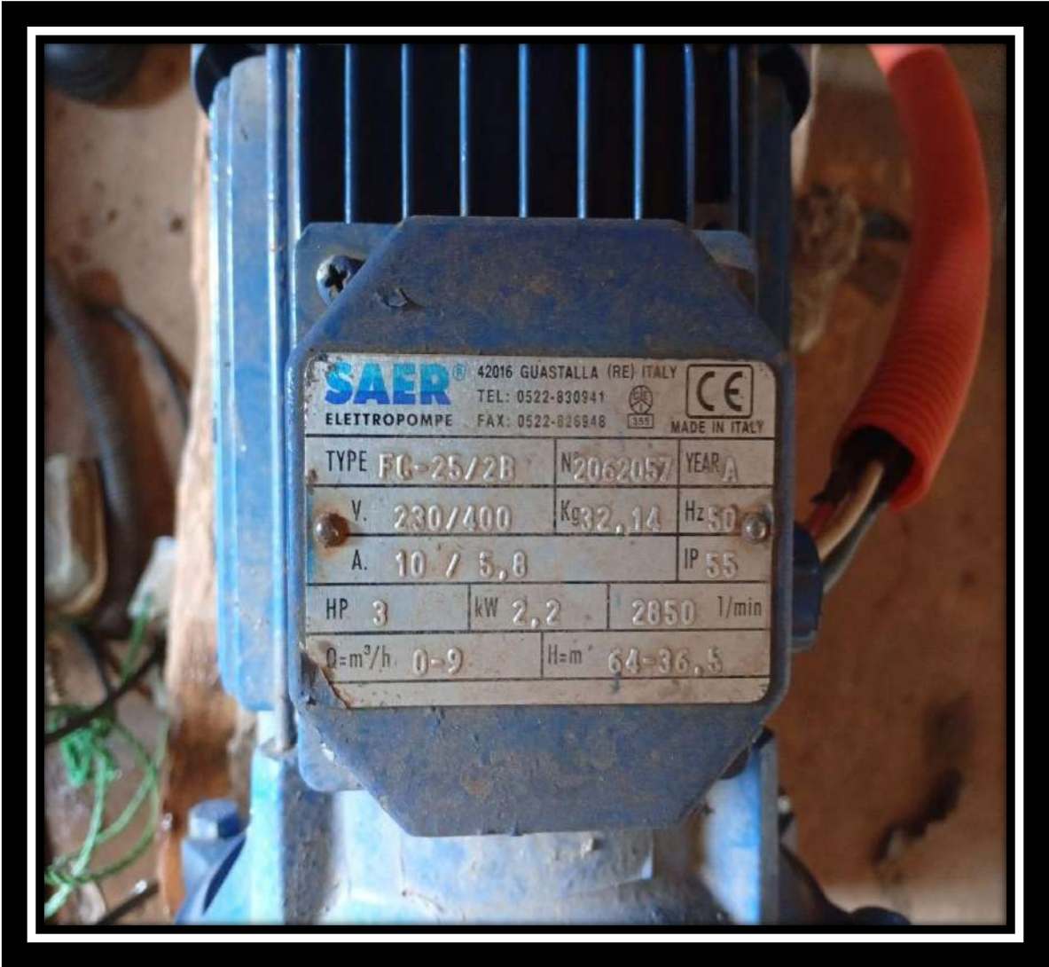
Ilustración 9 Especificaciones técnicas del motor trifasico en funcionamiento
