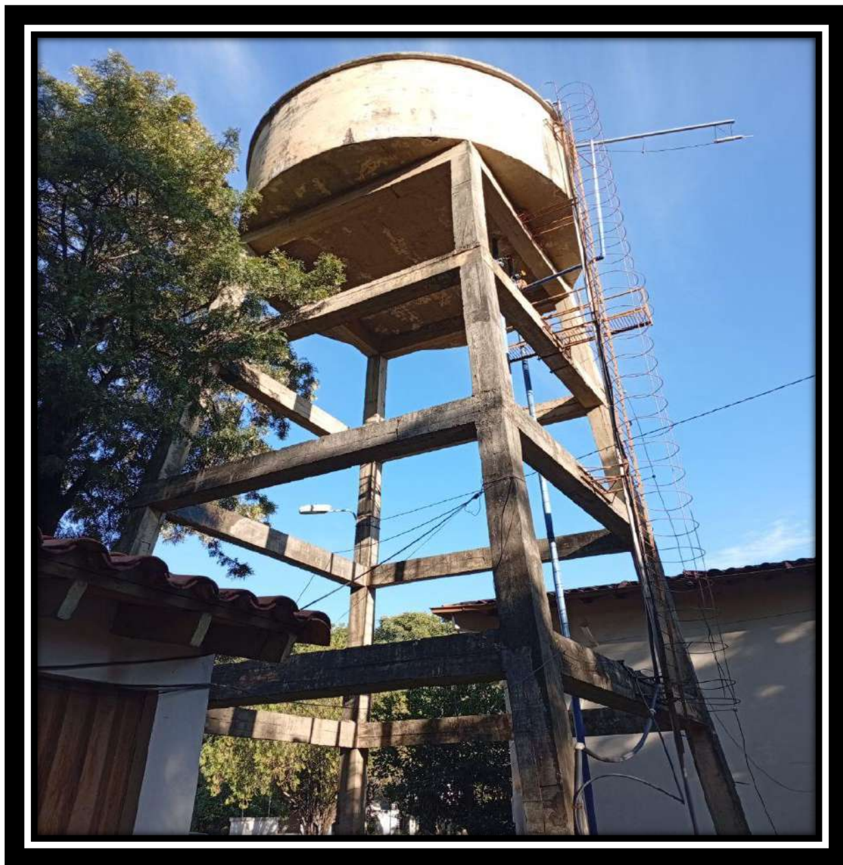
Ilustración 7 Tanque principal del Hospital Materno Infantil
