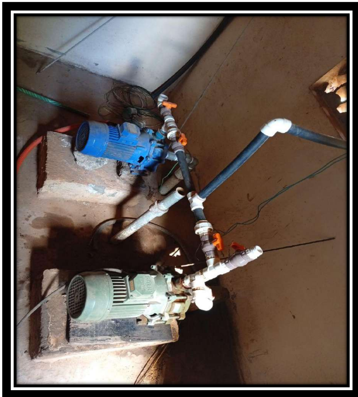
Ilustración 23 Accesorios de fontanería en la salida de los motores de empuje
