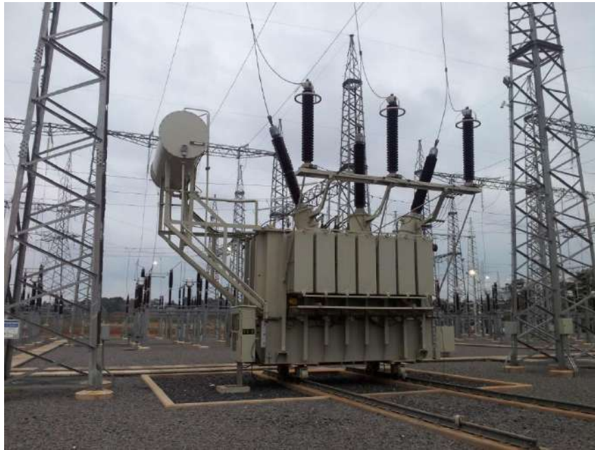
Figura 1. Transformador de Potencia de la Estación Paso Pe.
