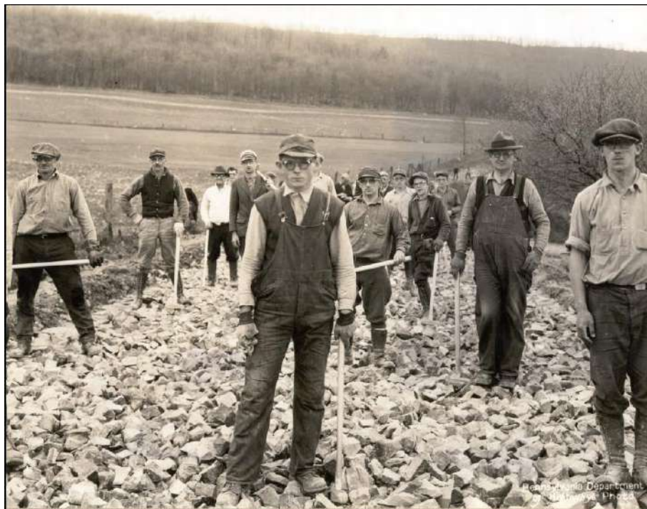
Ilustración 30: Construcción de la capa base, Operarios, con gafas y martillos para acabar de reducir los tamaños
