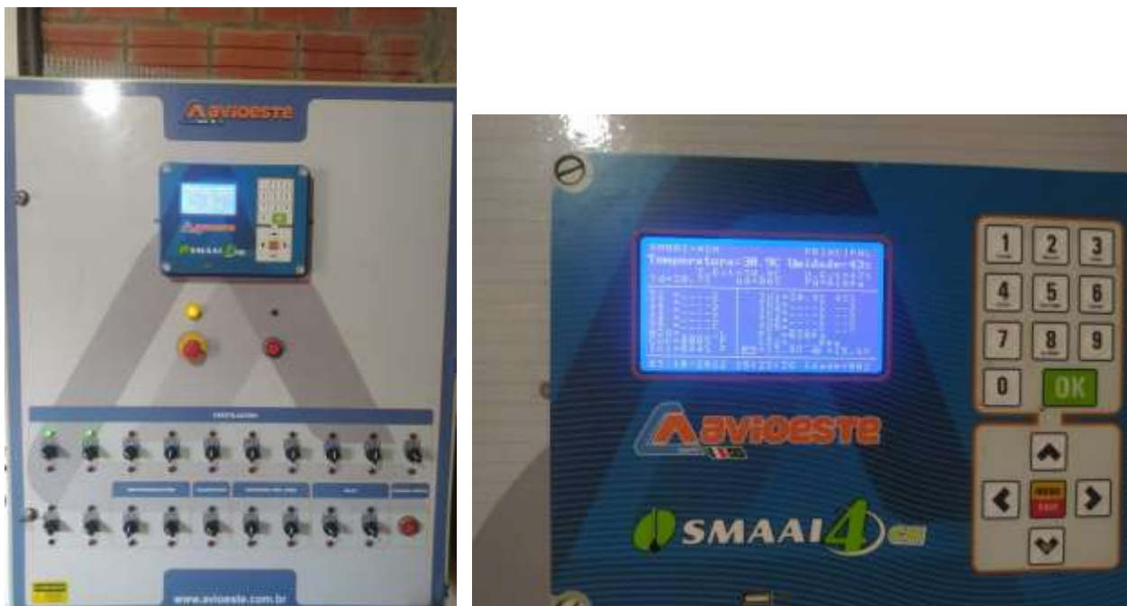
Ilustración 16: Controlador Smaai 4; Granja San Bernardo.
