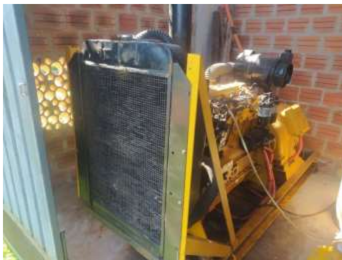
Ilustración 12: Suministro de Energía Eléctrica – Grupo Generador 75 KVA – Granja San Bernardo.
