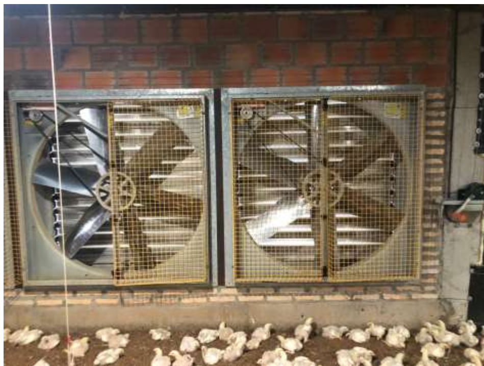
Ilustración 21: Sistema de Extractor - Granja San Bernardo
