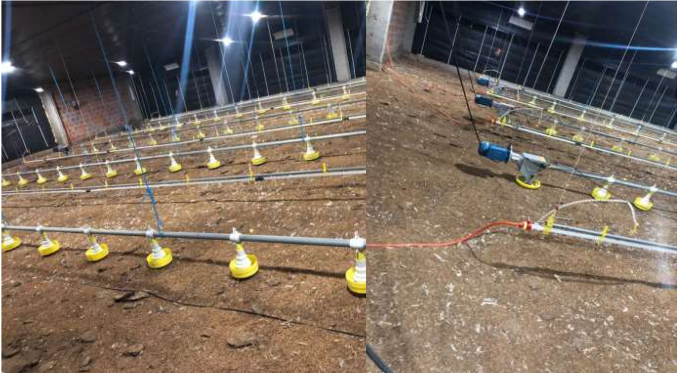
Ilustración 10: Alimentador Automático – Granja San Bernardo.
