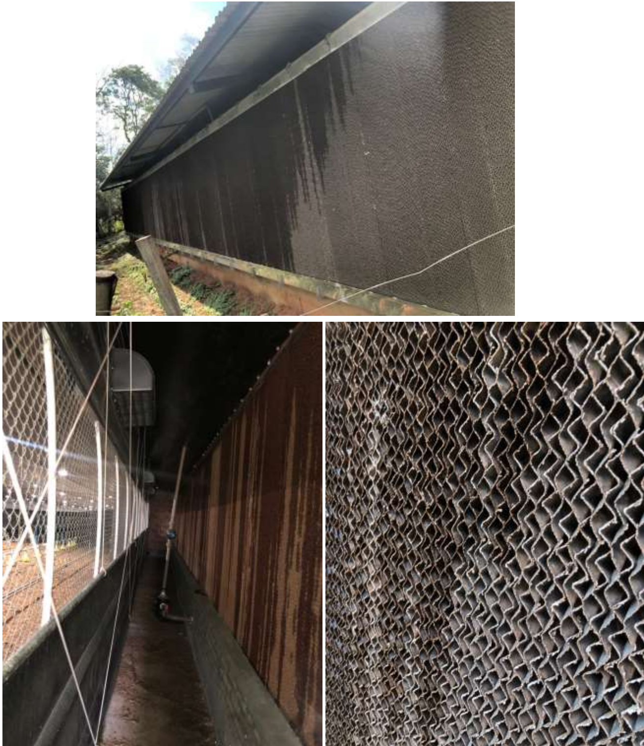
Ilustración 18: Sistema de enfriamiento evaporativo Cooling - Granja San Bernardo.
