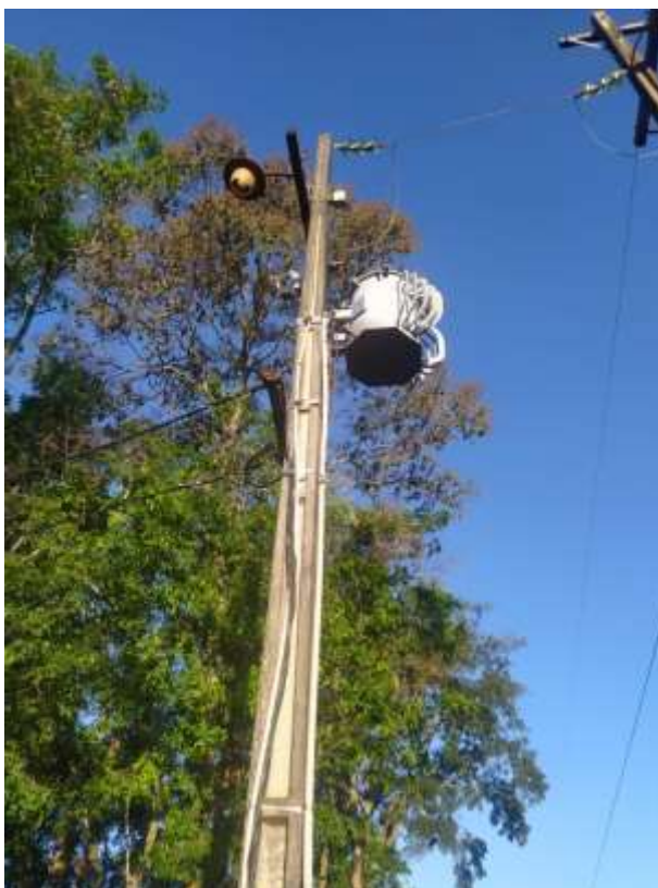
Ilustración 14: Suministro de Energía Eléctrica – Transformador 75KVA – Granja San Bernardo. La iluminación del Galpón es con lámparas led avilamp, son lámparas con tecnología LED certificada por Inmetro, resistente y durable, se destaca por su excelente eficiencia luminosa, no geran calor y, además de ser amigables con el medio ambiente, evita el desperdicio de luz,
