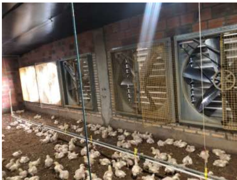
Ilustración 20: Sistema de Extractor - Granja San Bernardo.
