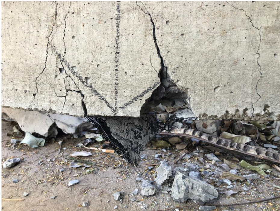
Rotura a Flexión Viga Hormigon Armado con refuerzo
