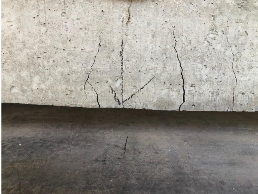
Rotura a Flexión Viga Hormigon Armado sin refuerzo
