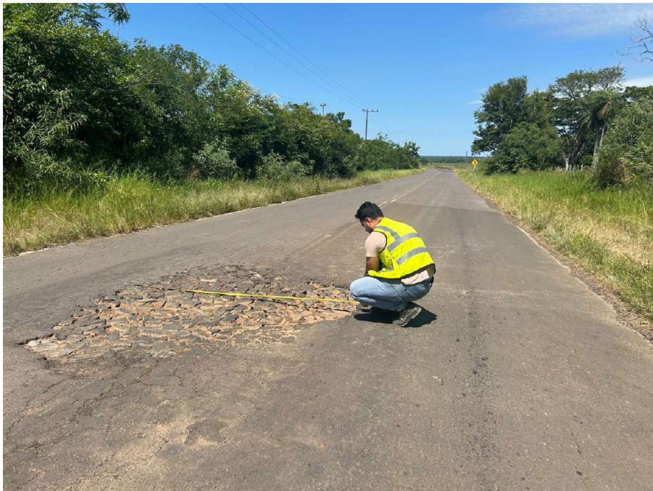
Anexo 4.1. Proceso de relevamiento de fallas
