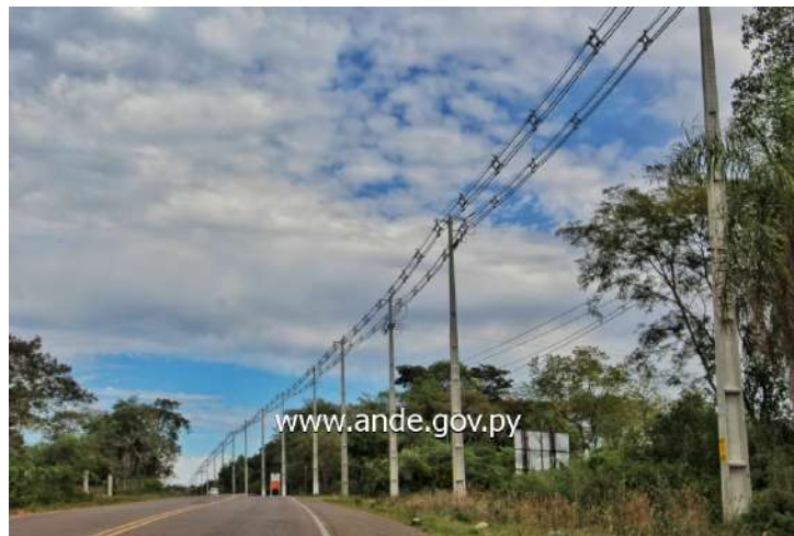
Figura 2.1: Línea aérea protegida, fuente: ANDE
