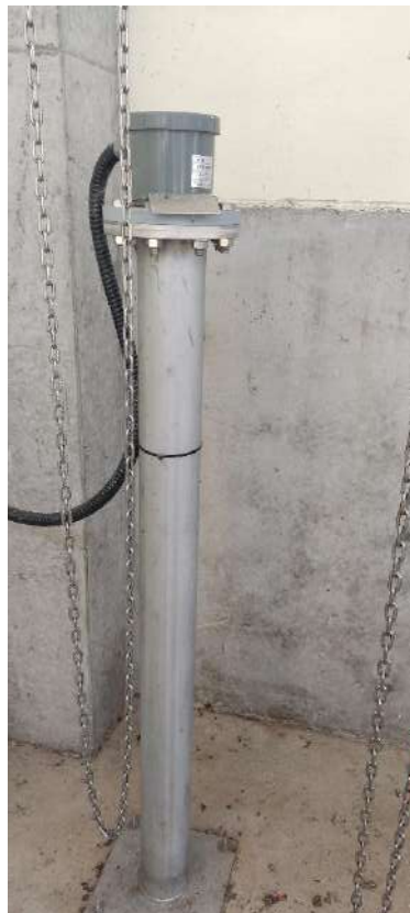
Figura 18: Sensor de nivel de la sala de bombeo
