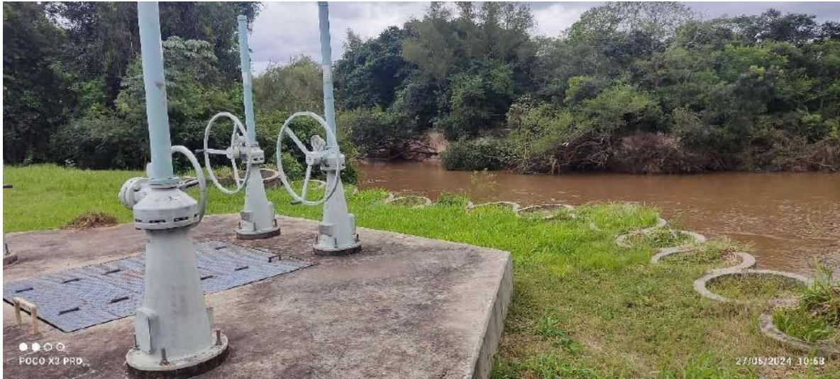
Figura 15: Válvulas para la captación de agua
