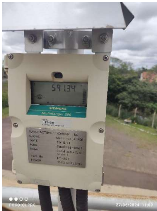
Figura 20: Caudalímetro de la entrada a la planta
