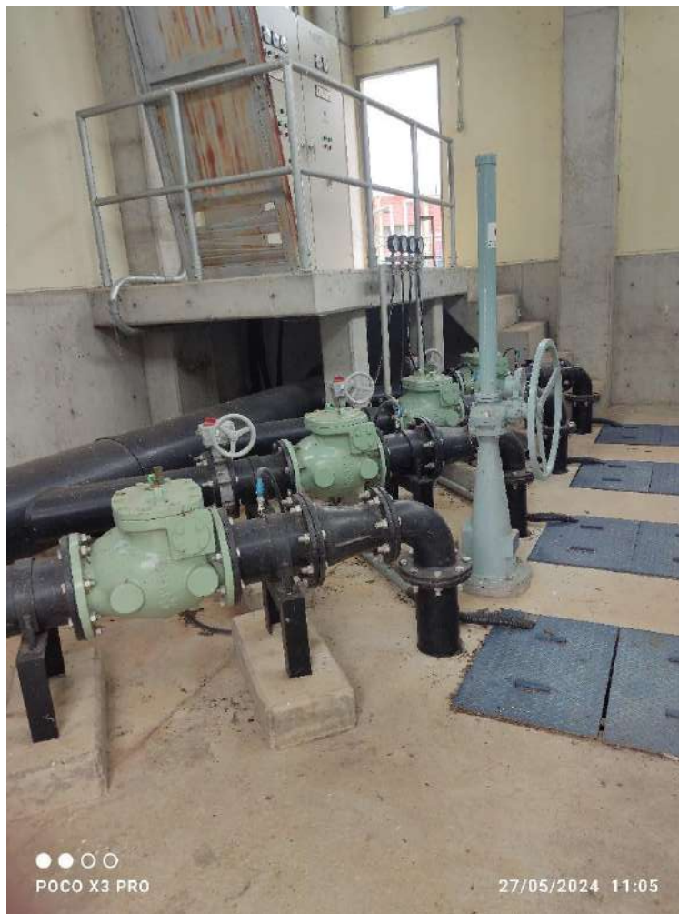
Figura 16: Sala de bombeo
